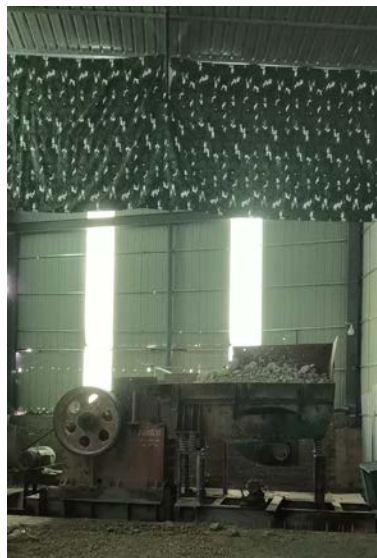
颚式破碎机废气收集措施
