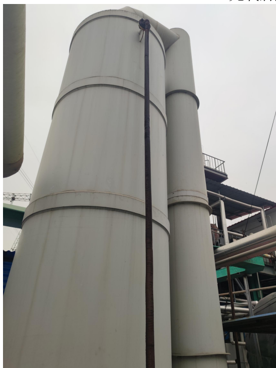
废气处理设施一级碱吸收装置
