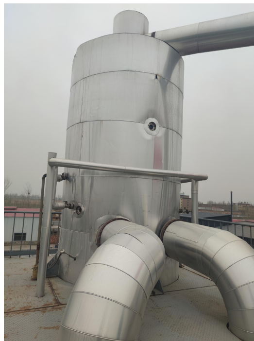
MVR 装置分离室
