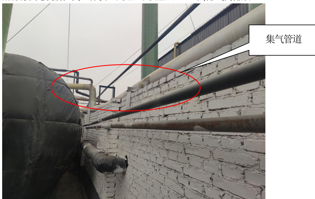
废水收集罐上方集气管道图
