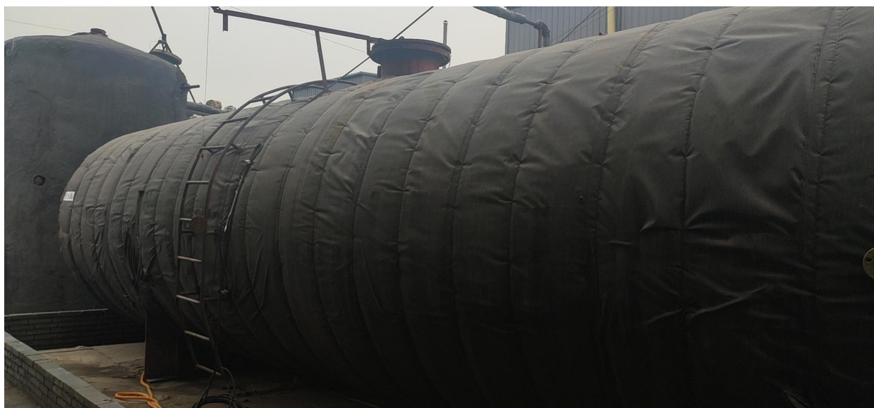
洗涤废水收集罐
